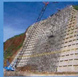
のり面工事の漏水に
