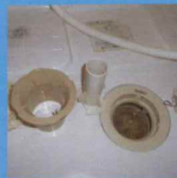
洗濯機排水口の漏水に
